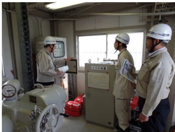
機側操作確認・点検（桂川）
